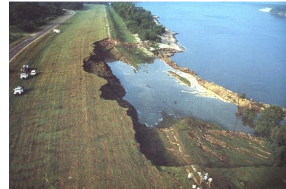
Foto de un dique roto
