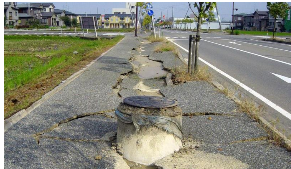
Licuefacción del terremoto de Chuetsu de 2004
